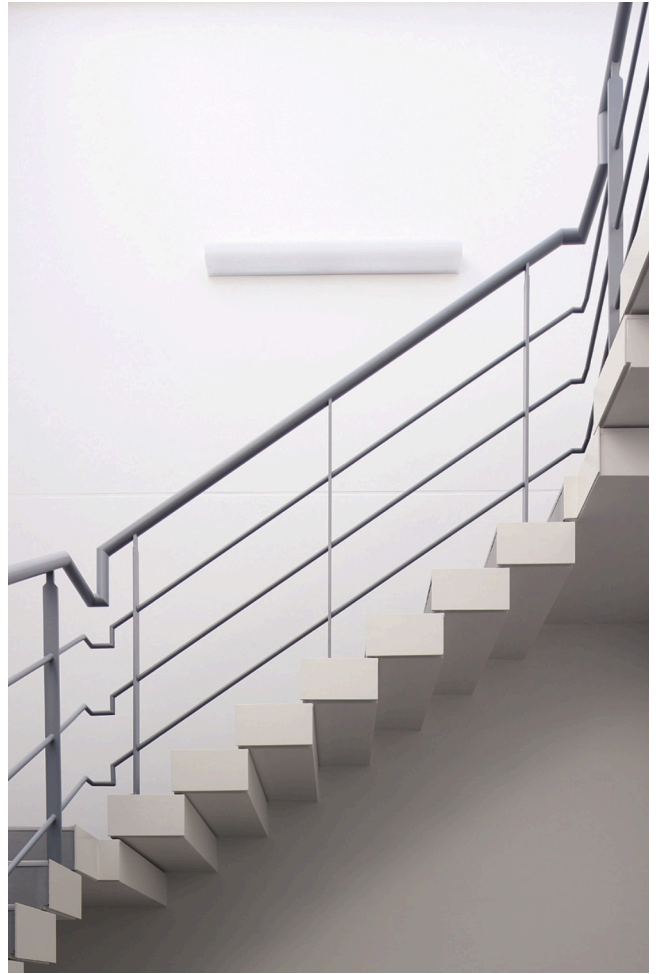
階段、キャンティレバー構造の段板の間に隙間がある。
